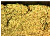
Formazione di incrinature dovute a materiale impuro
